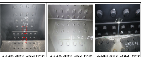
【사진 3.6】 강박스 거더 내부 손상현황
