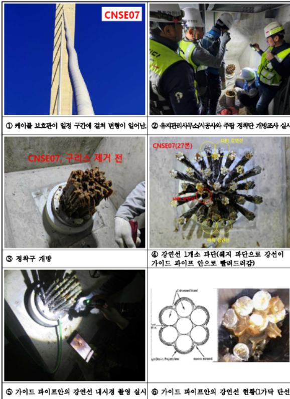
[사진 3.18] 케이블 강연선 슬립 CNS07 조사 현황 - 1
