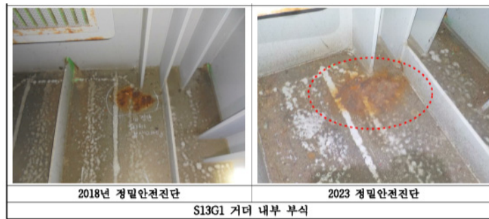
【그림 3.16】 거더내부 수분유입 차단 및 부식발생 현황
