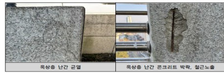
옥상층 난간 균열
