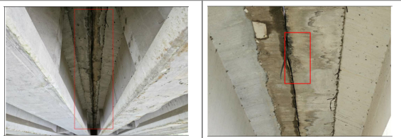
종방향 신축이음 누수에 의한 바닥판 손상
